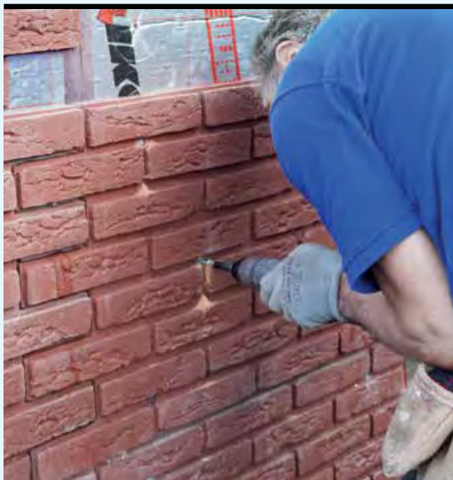
Deze vertands geproduceerde panelen worden met schroeven bevestigd op de oude gevel.
